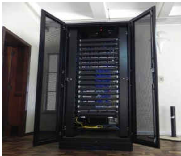
Figura A.13.1.8.1.2-K.2 – Infraestrutura de rede lógica
